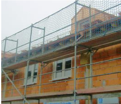
Bild: Dachfang- gerüst
