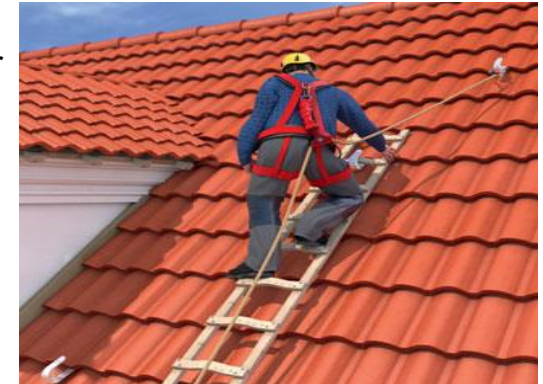
Bild: Auflegeleiter und persönliche Schutz- ausrüstung (z.B. für kürzere Einsätze)
